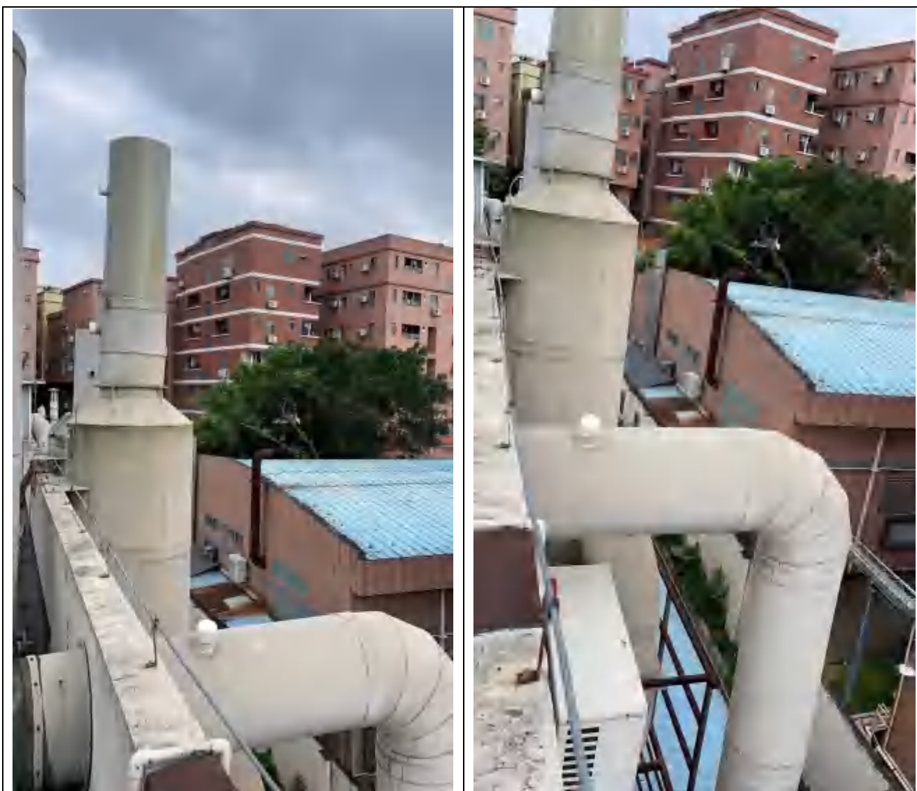
“碱液喷淋+除雾装置+活性炭吸附”废气处理装置
