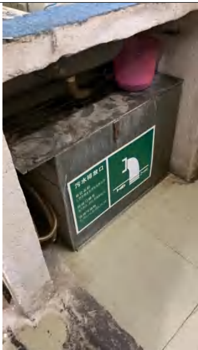
生产废水沉淀池
