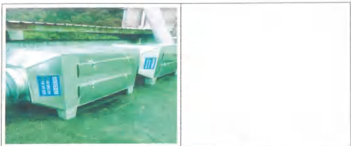
“二级活性炭吸附” 废气处理装置
